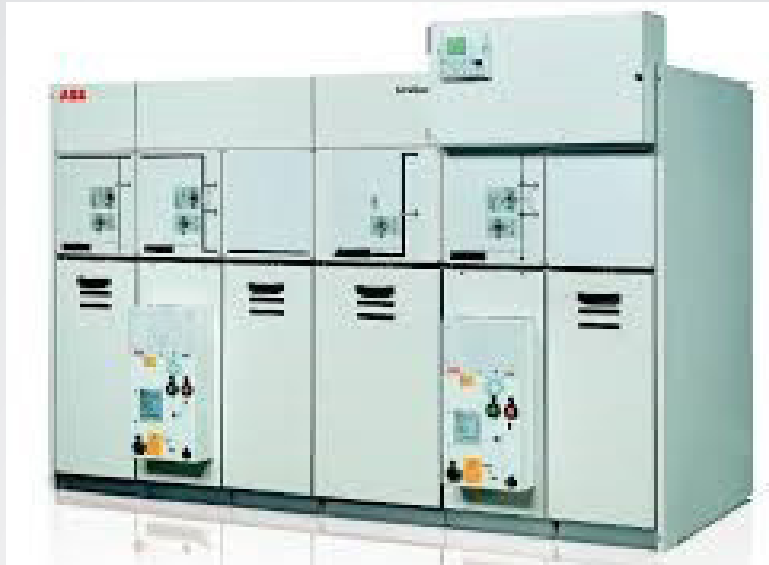
Fig. 3. Celdas de media tensión con seccionadores e potencia aislados en SF6
