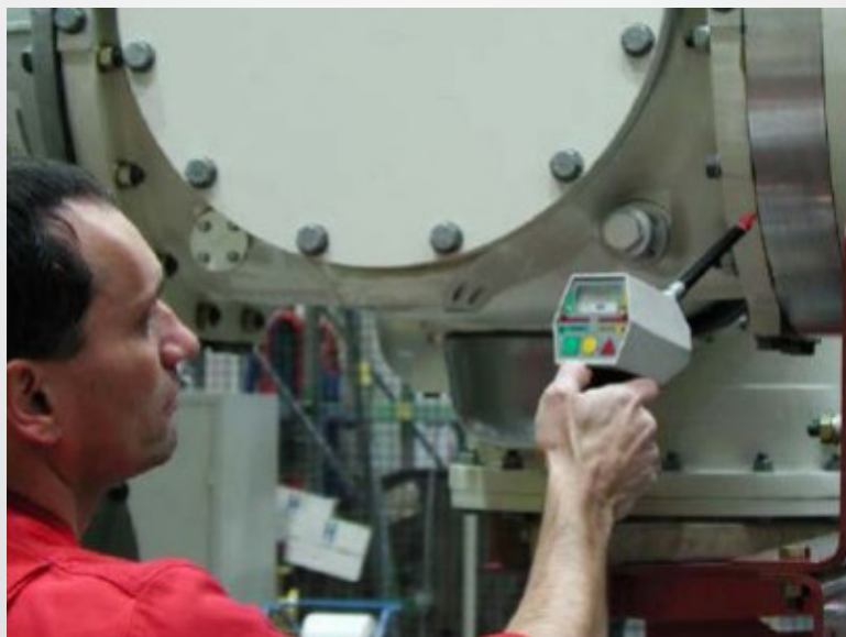
Fig. 4. Detección de fuga de gas SF6 en una subestación eléctrica
