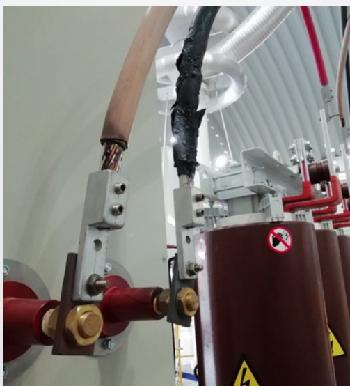
Fig. 1. Falso contacto en instalaciones.
