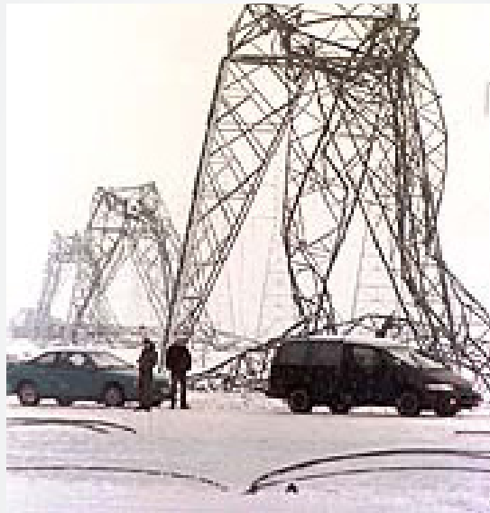
Fig. 2: Daños a varias torres de alta tensión por efecto Galloping.
