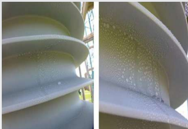
Fig. 6. Hidrofobicidad del aislador después de aplicar el recubrimiento con silicona RTV. Fuente: CSL SILICONES INC.
