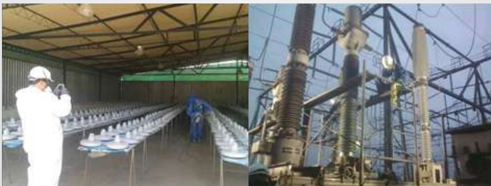
Fig. 5. Recubrimiento de silicona RTV SI-COAT 570 en planta y en subestación realizado por la empresa SILICON TECHNOLOGY SAC.
