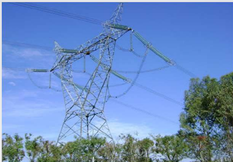
Fig. 9. Torre de transposición en Línea de 500kV.
