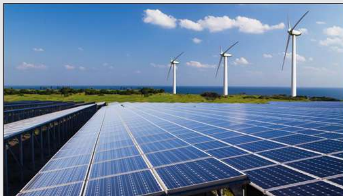
Fig. N° 2. Paneles fotovoltaicos y aerogeneradore
