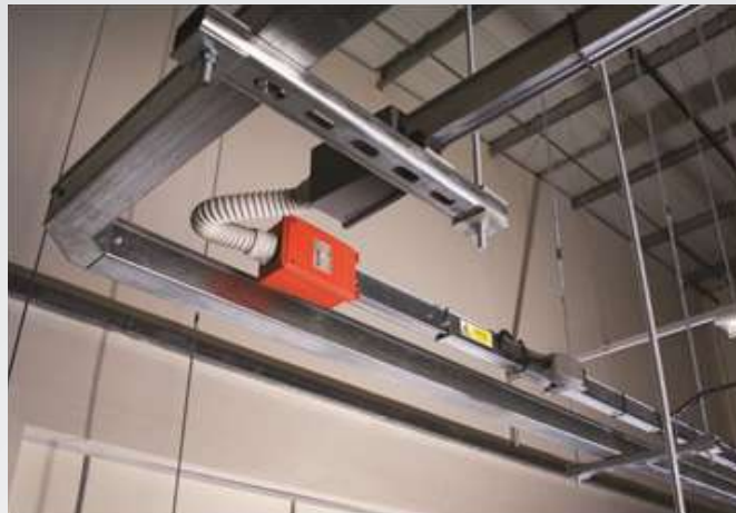
Fig. 3. Ductos de barras instalados.
