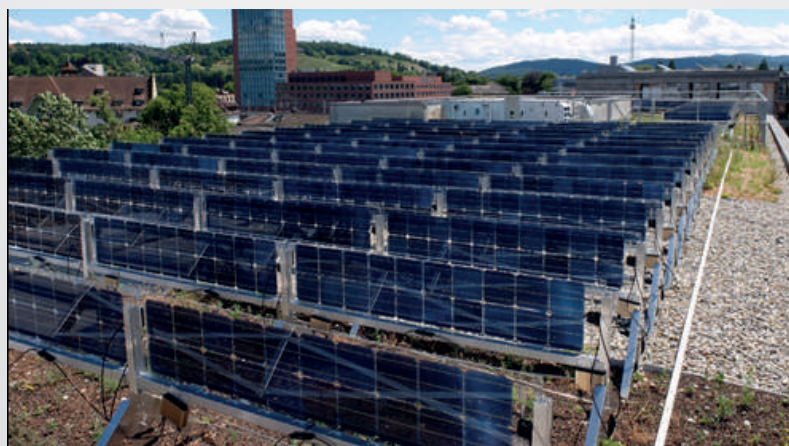
Fig. 5. Instalación vertical de paneles fotovoltaicos bifaciales.
