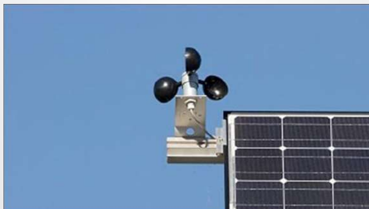
Fig. 8. Anemómetro instalado en panel solar.
