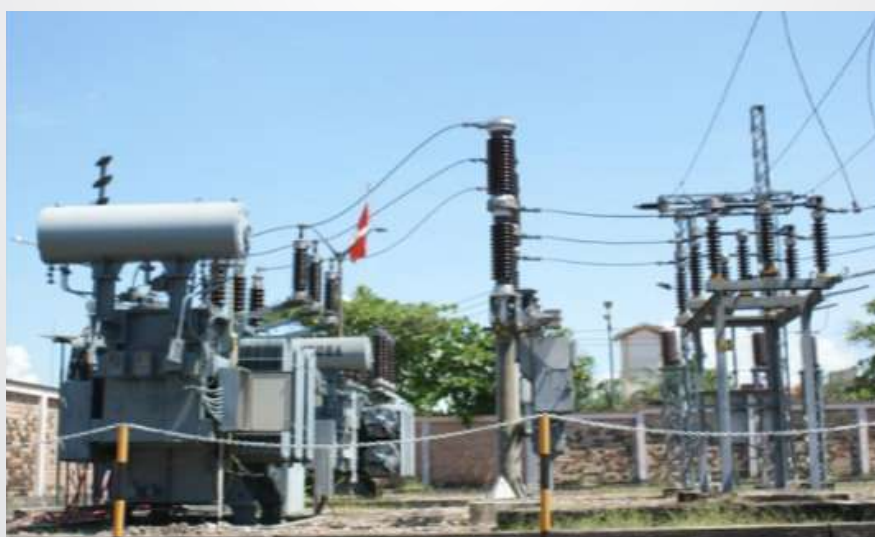
Fig. 1. Subestación eléctrica de transmisión.
