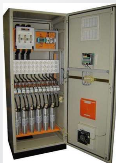
Fig. 2. Banco de condensadores.
