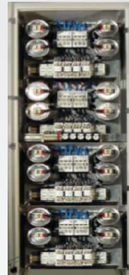
Fig. 5. Banco de condensadores.
