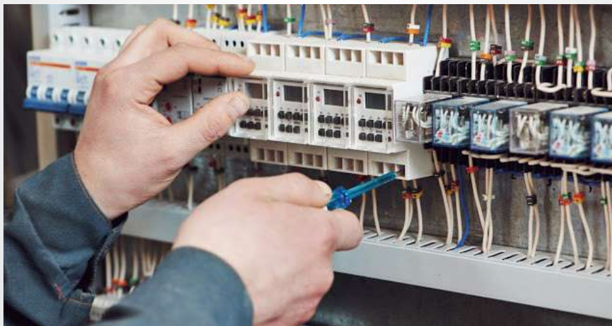
Fig. 1. Protecciones eléctricas a nivel industrial / Fuente: https://www.syscomblog.com/2019/09/tipos-de-proteccion-electrica-que-debe.html
