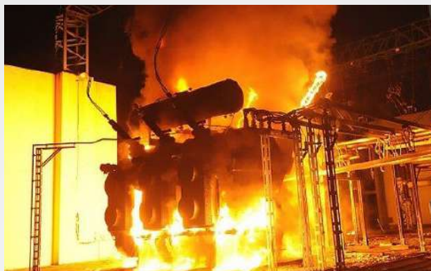
Fig. 3. Fallo e incendio de transformador en aceite
