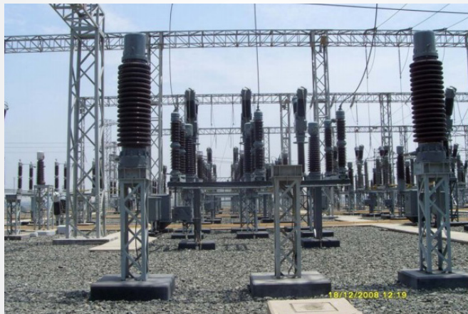
Fig. 1. Equipos de maniobra/ Fuente: https://n9.cl/82fra
