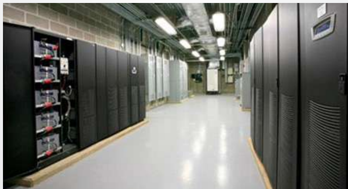
Fig. 1. Sistema de UPS / Fuente: https://sistemasups.com.mx/sistemas-ups-industrial.html
