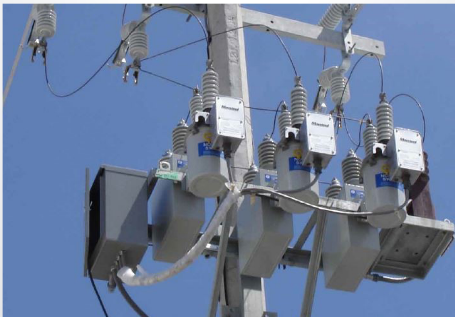
Fig. 3. Banco de condensadores / Fuente: https://br.pinterest.com/betholoaiza/banco-de-condensadores/
