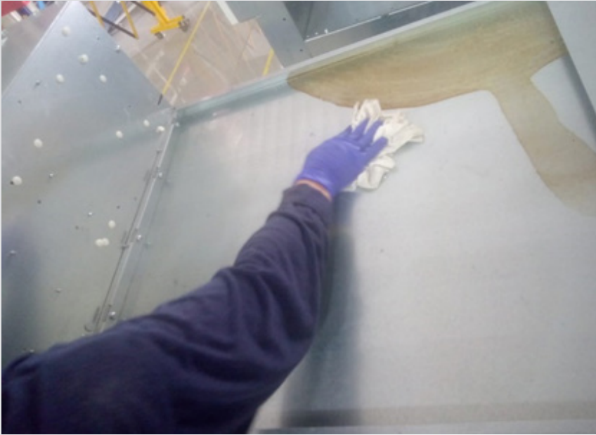
ESTADO DE GABINETE SUPERIOR EXTERNO DE GRUPO DE CELDAS DE MEDIA TENSIÓN.
