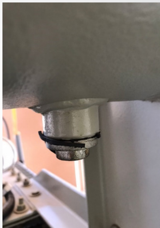
EMPAQUETADURA DE LA VÁLVULA DE VACIADO DEL DEPÓSITO DE EXPANSIÓN.
