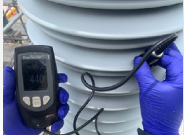
MEDICIÓN DE ESPESOR DE RECUBRIMIENTO EN TRANSFORMADOR DE TENSIÓN.
