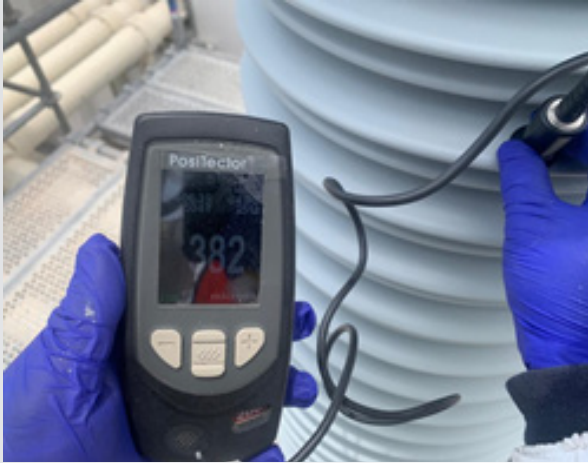
MEDICIÓN DE ESPESOR DE RECUBRIMIENTO EN AISLADOR TIPO BUJE DE GIS.
