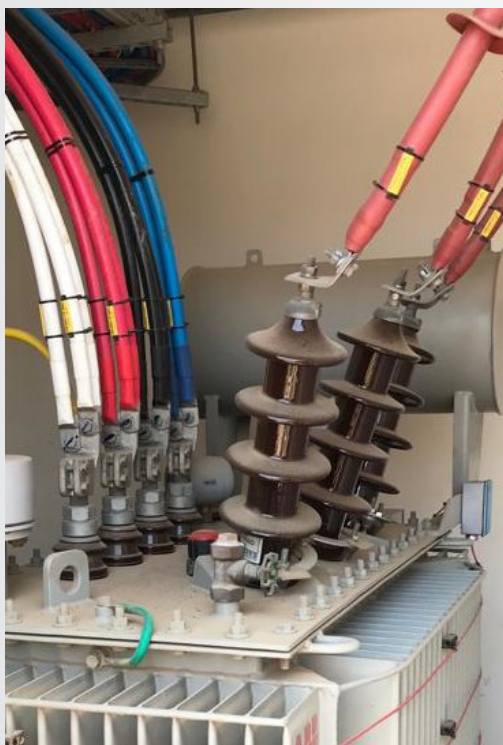
ACUMULACIÓN DE POLVO EN BUSHINGS Y PARTES ACTIVAS DEL TRANSFORMADOR.
