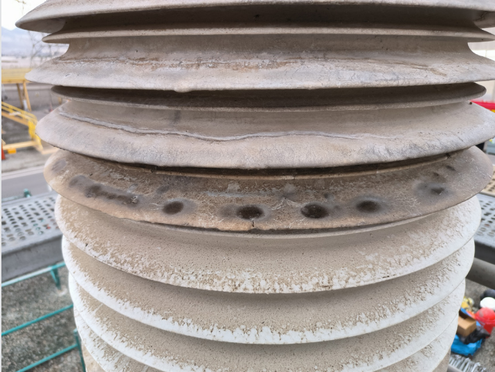
INDICIOS DE DESCARGAS PARCIALES FOCALIZADAS EN TERMINAL DE CABLE FASE T (GSU11)
