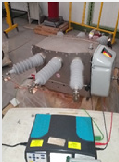
MEDICION DE RESISTENCIA DE AISLAMIENTO
