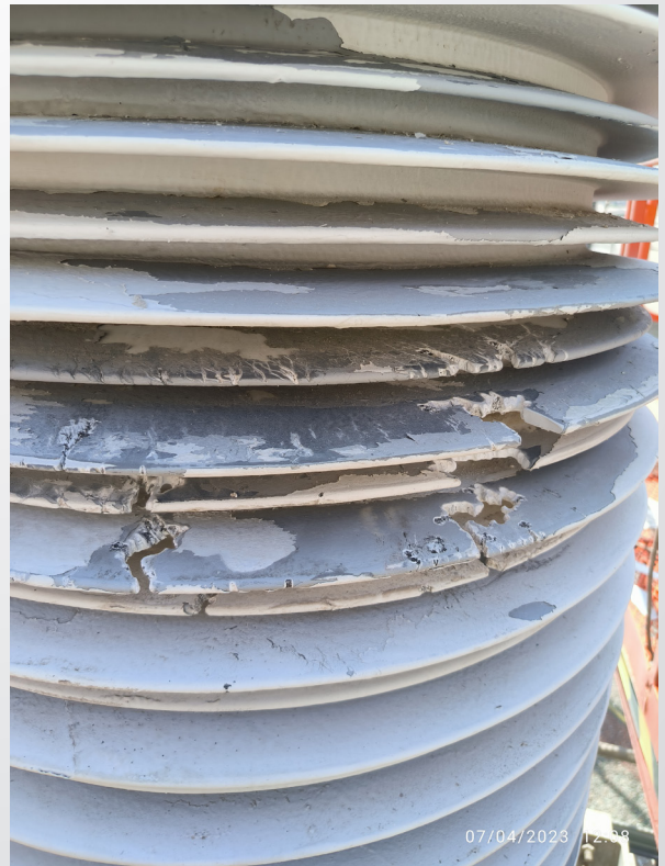
PERFORACIONES EN LAS ALETAS POLIMÉRICAS POR DESCARGAS PARCIALES - PARARRAYOS FASE S. (PÓRTICO DE L-5011)
