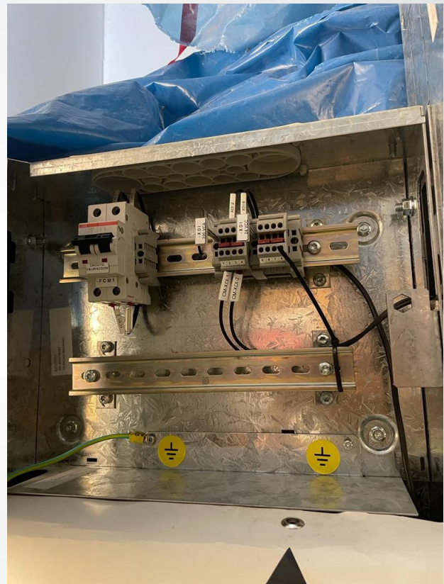
LLEGADA DE ALIMENTACIÓN 220VAC - CELDA DE LLEGADA (CELDA DE PROTECCIÓN Y MEDICIÓN)
