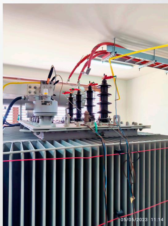
ENSAYOS ELÉCTRICOS A TRANSFORMADORES.
