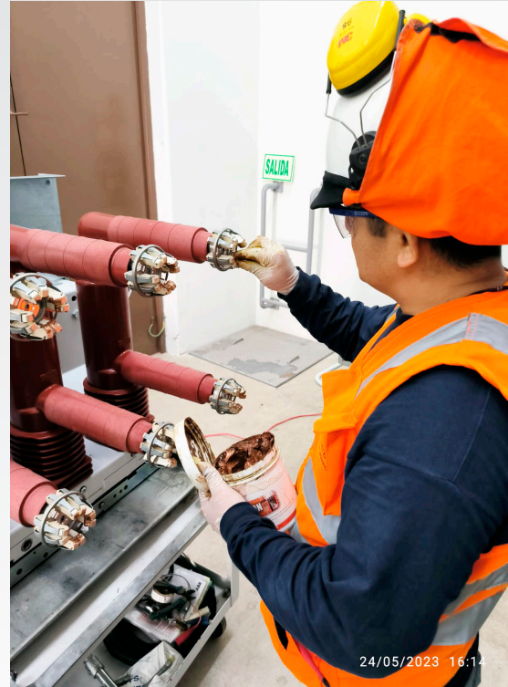
APLICACIÓN DE GRASA CONDUCTIVA EN CONTACTOS DE INTERRUPTOR.
