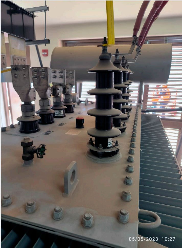
ACUMULACIÓN DE POLVO EN BUSHINGS Y PARTES ACTIVAS DE TRANSFORMADORES 2875 KVA.
