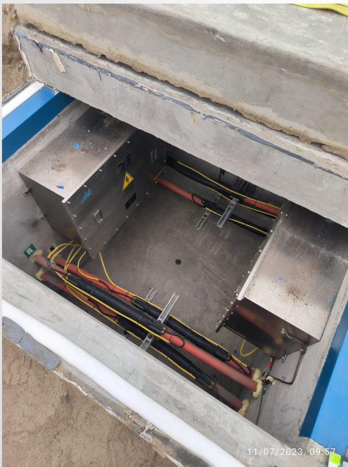
RED ELÉCTRICA SUBTERRÁNEA
