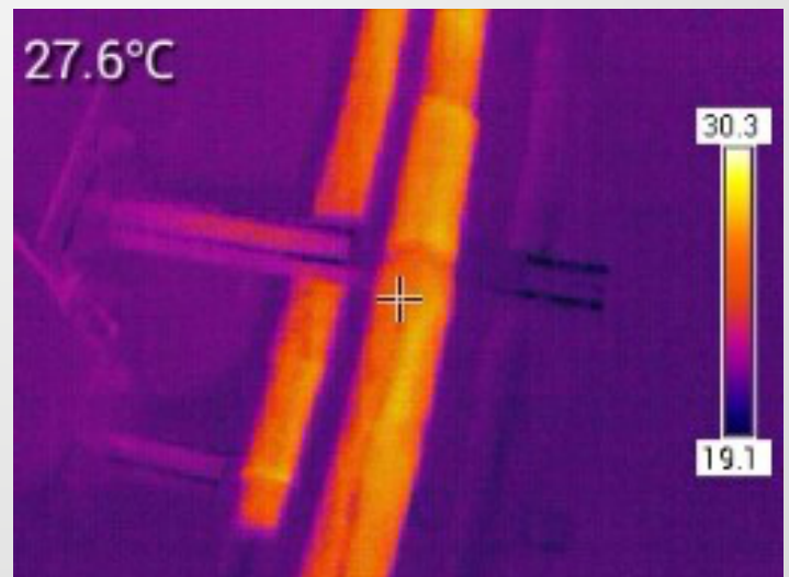
MEDICIÓN TERMOGRÁFICA DE LA RED ELÉCTRICA SUBTERRÁNEA
