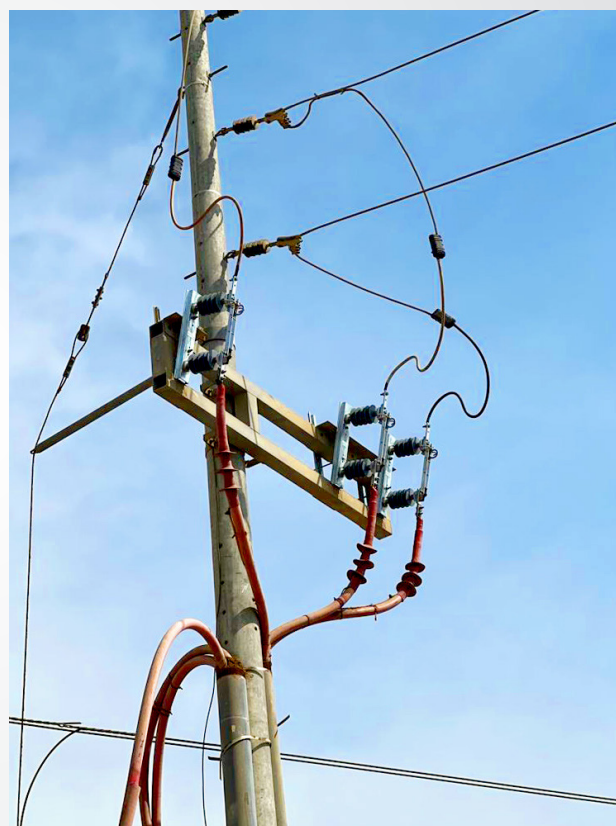
INSTALACIÓN DE SECCIONADORES – POSTE SECCIONADOR
